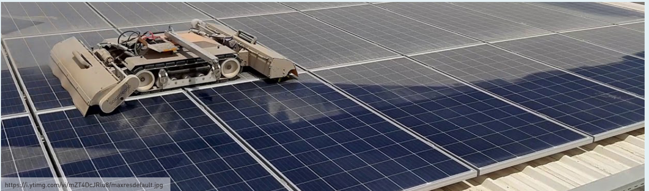
Güneş Paneli Temizliğinde Kuru Temizlik Robotu
