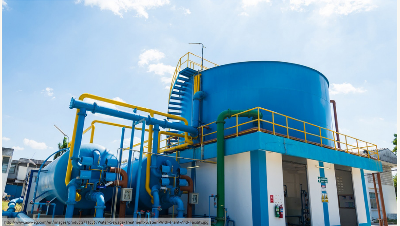
Endüstriyel Atıksu Arıtma Tesisi
