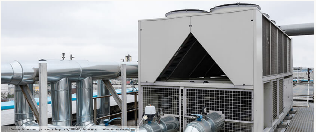
Soğutma Sistemleri (Chiller)
