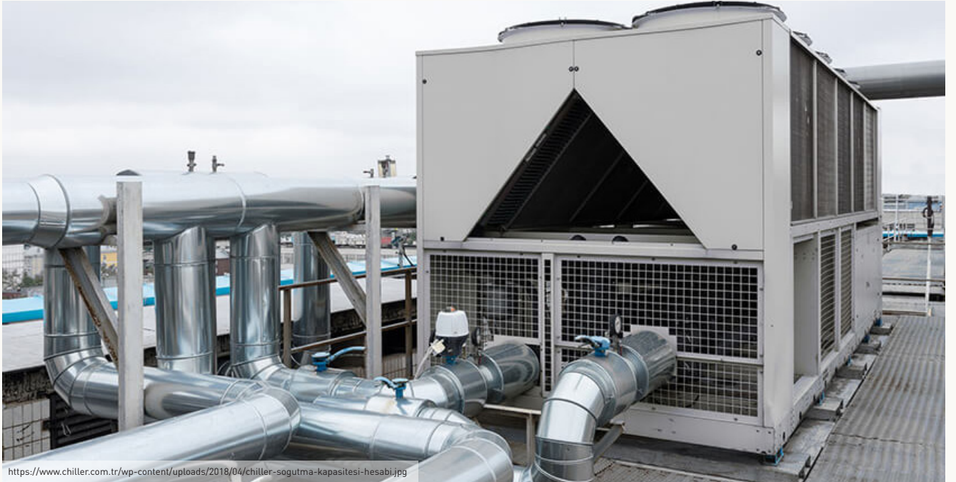
Soğutma Sistemleri (Chiller)
