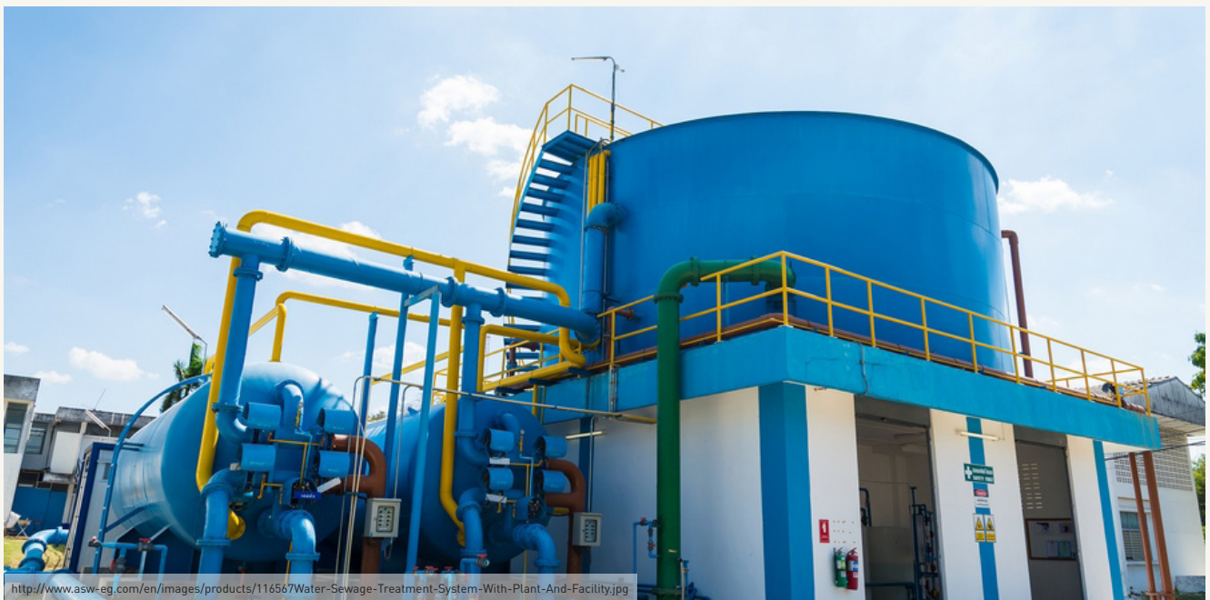
Endüstriyel Atıksu Arıtma Tesisi
