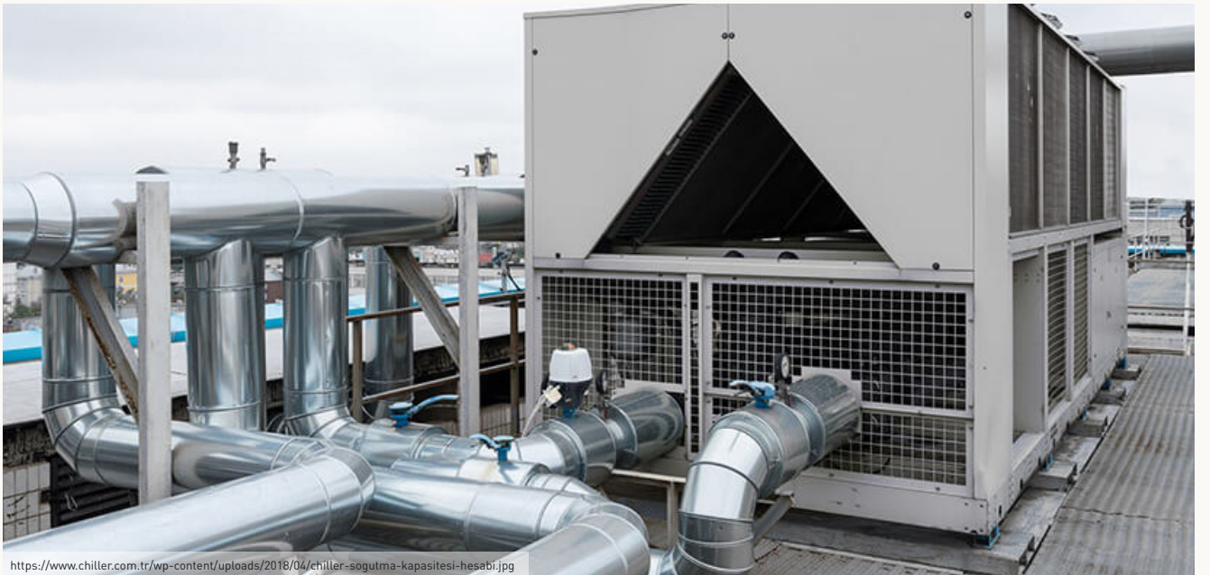
Soğutma Sistemleri (Chiller)
