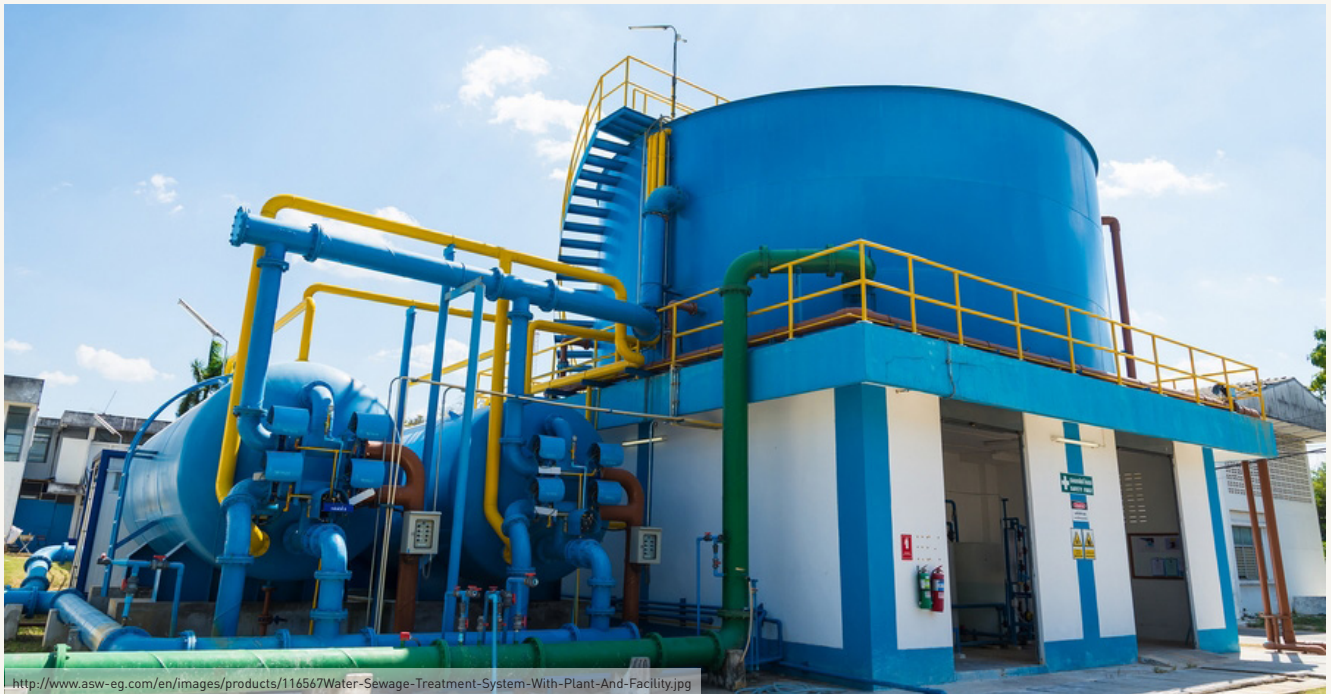
Endüstriyel Atıksu Arıtma Tesisi
