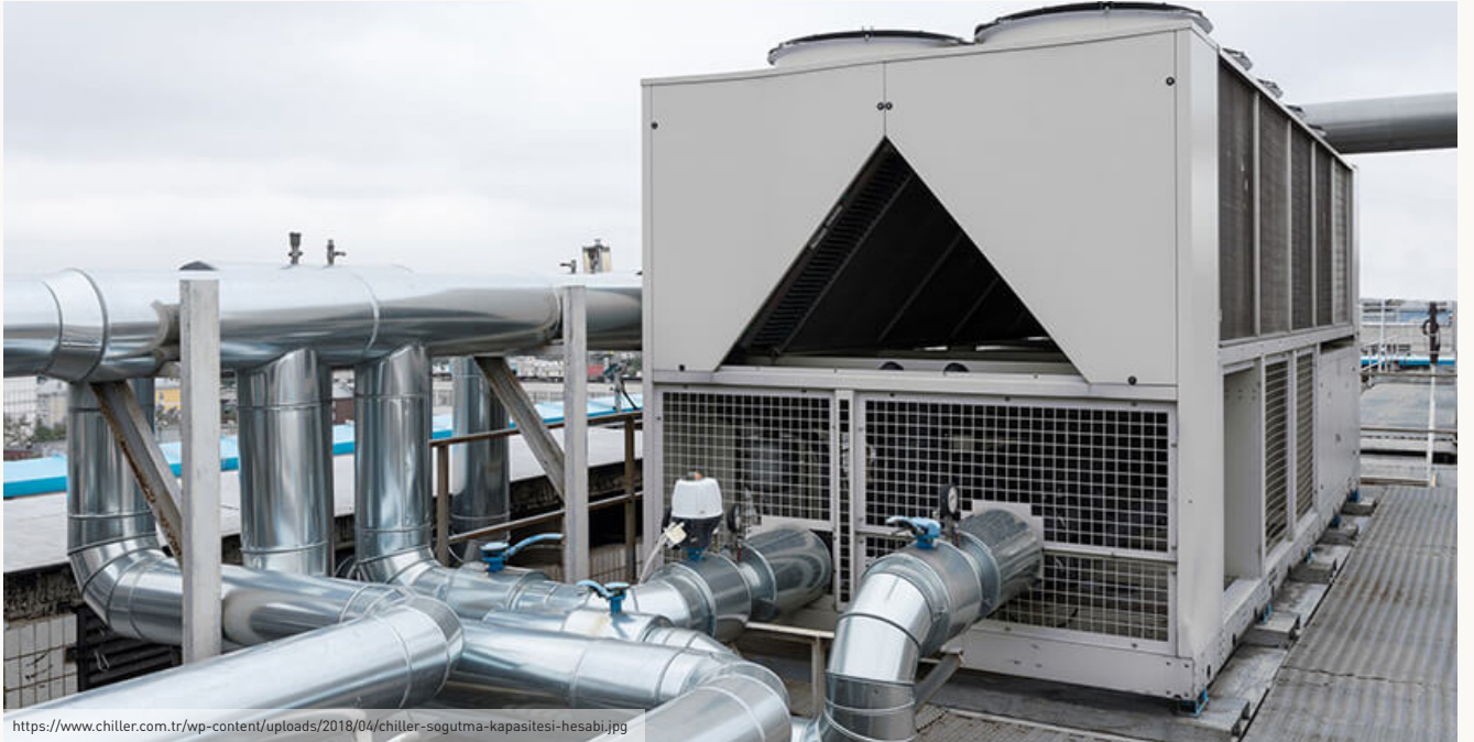
Soğutma Sistemleri (Chiller)
