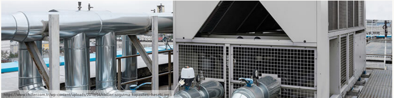
Soğutma Sistemleri (Chiller)
