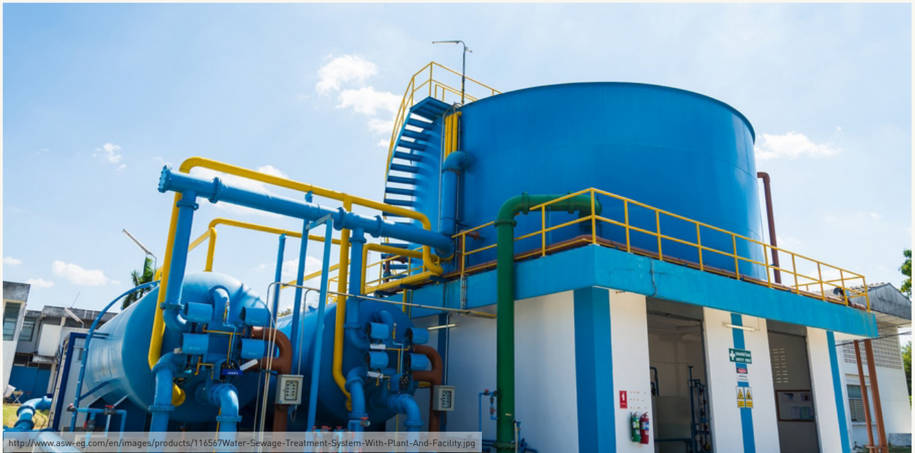
Endüstriyel Atıksu Arıtma Tesisi
