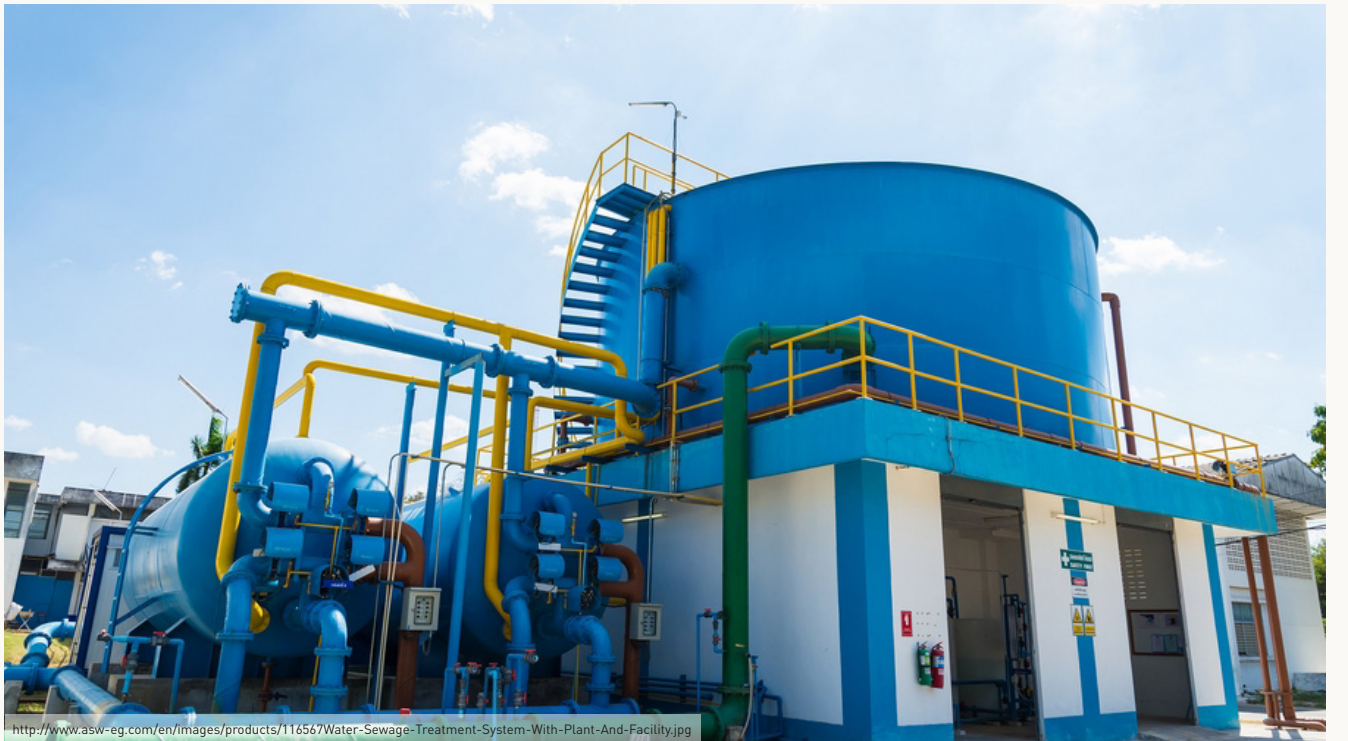
Endüstriyel Atıksu Arıtma Tesisi
