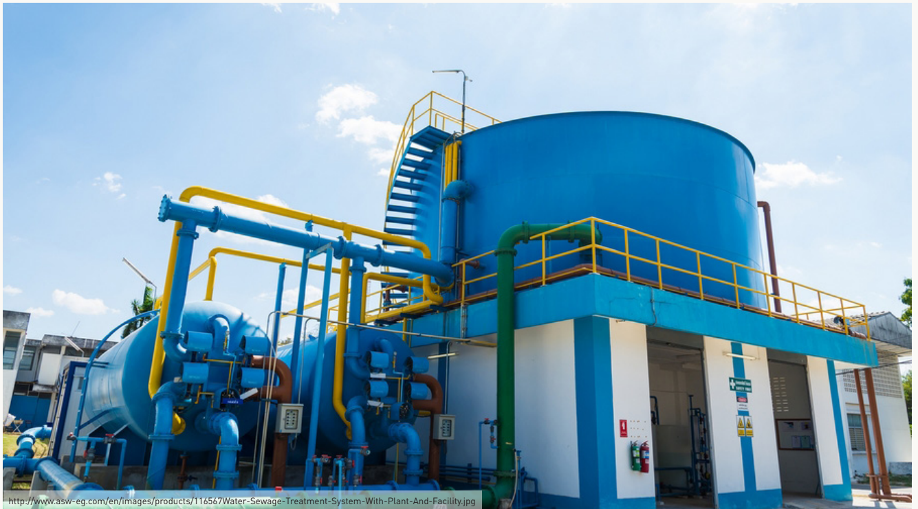
Endüstriyel Atıksu Arıtma Tesisi
