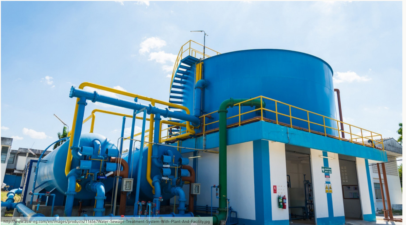
Endüstriyel Atıksu Arıtma Tesisi
