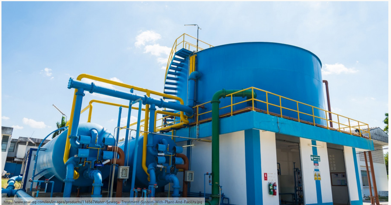
Endüstriyel Atıksu Arıtma Tesisi
