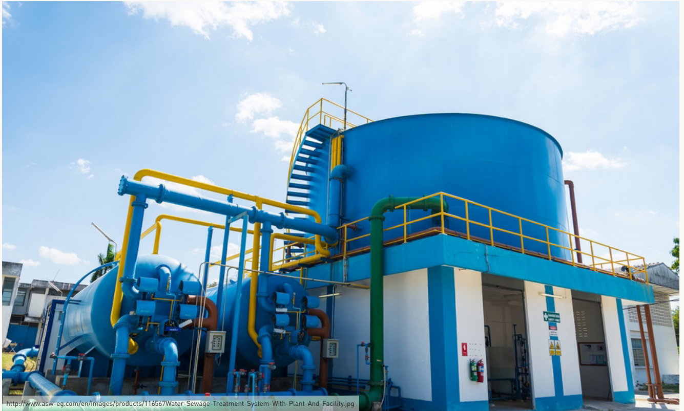
Endüstriyel Atıksu Arıtma Tesisi
