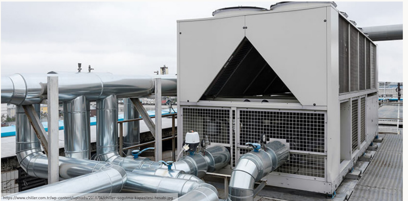
Soğutma Sistemleri (Chiller)
