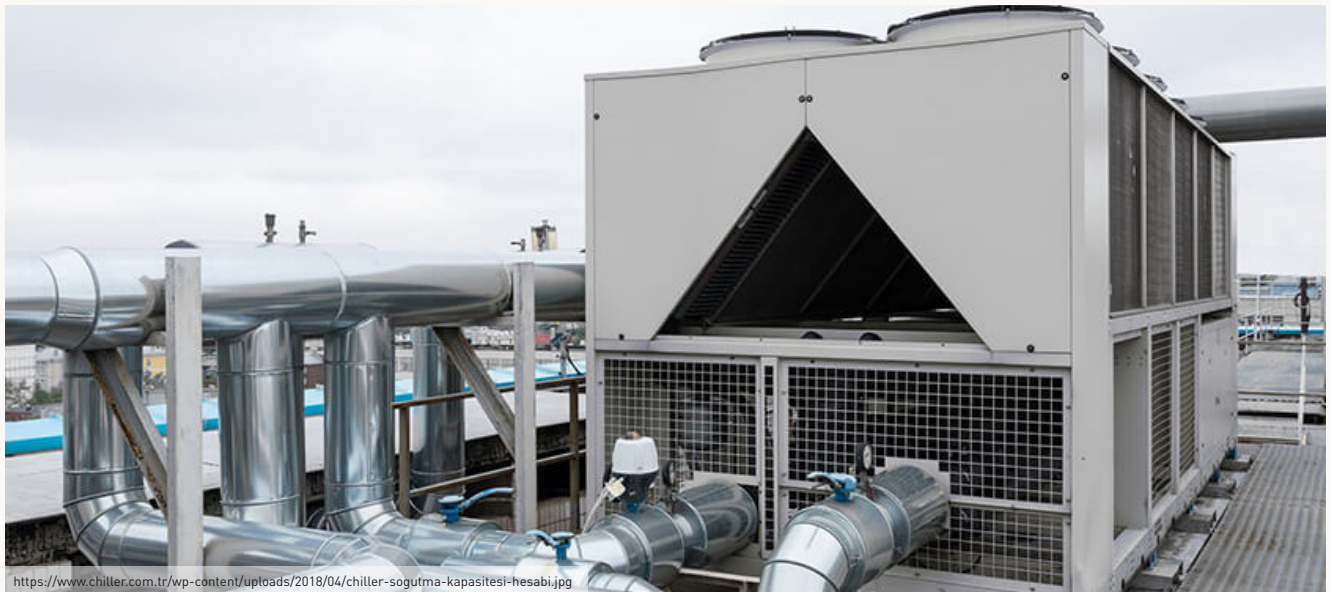
Soğutma Sistemleri (Chiller)
