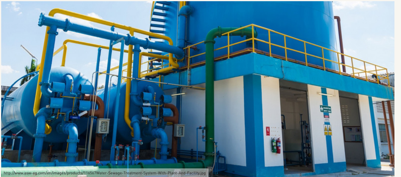
Endüstriyel Atıksu Arıtma Tesisi
