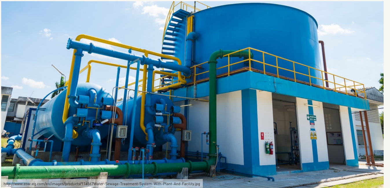
Endüstriyel Atıksu Arıtma Tesisi
