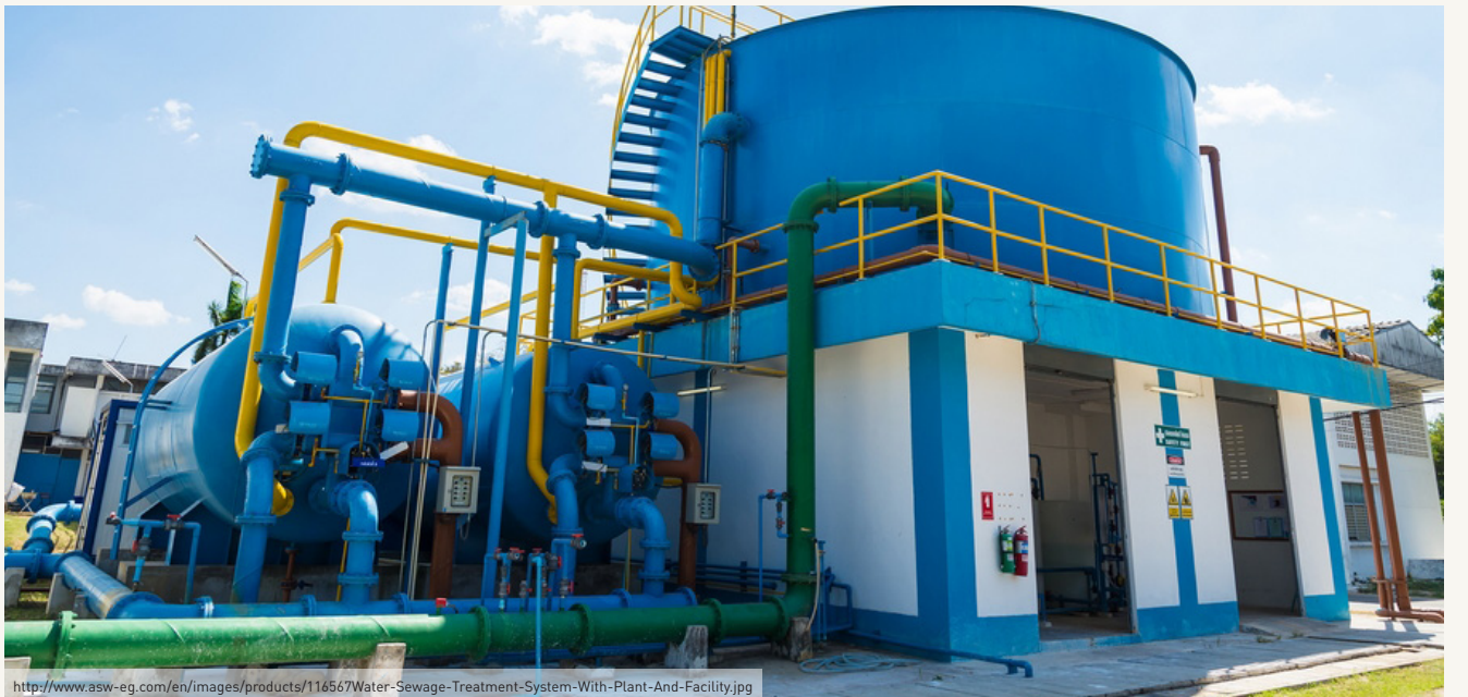
Endüstriyel Atıksu Arıtma Tesisi
