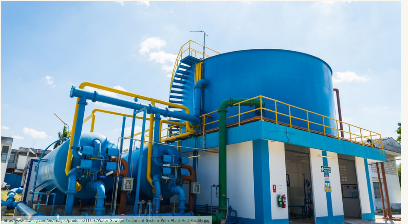
Endüstriyel Atıksu Arıtma Tesisi
