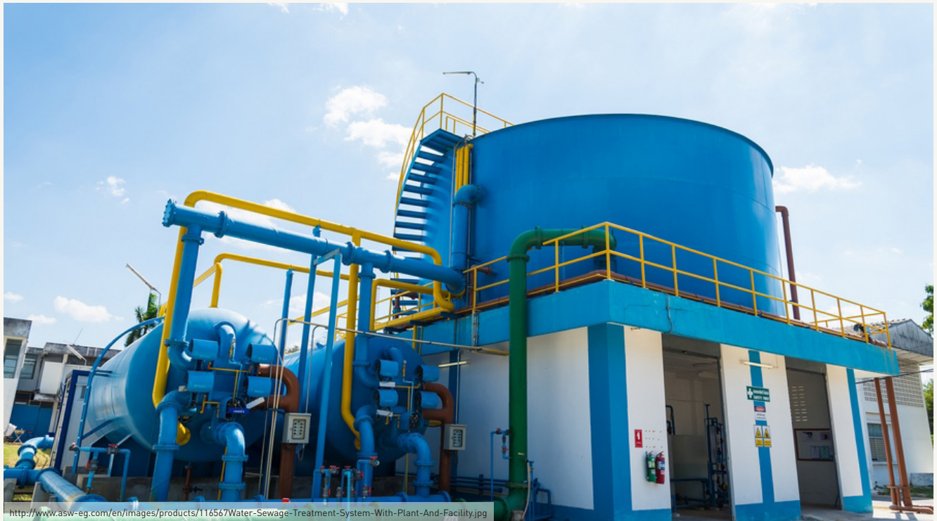
Endüstriyel Atıksu Arıtma Tesisi
