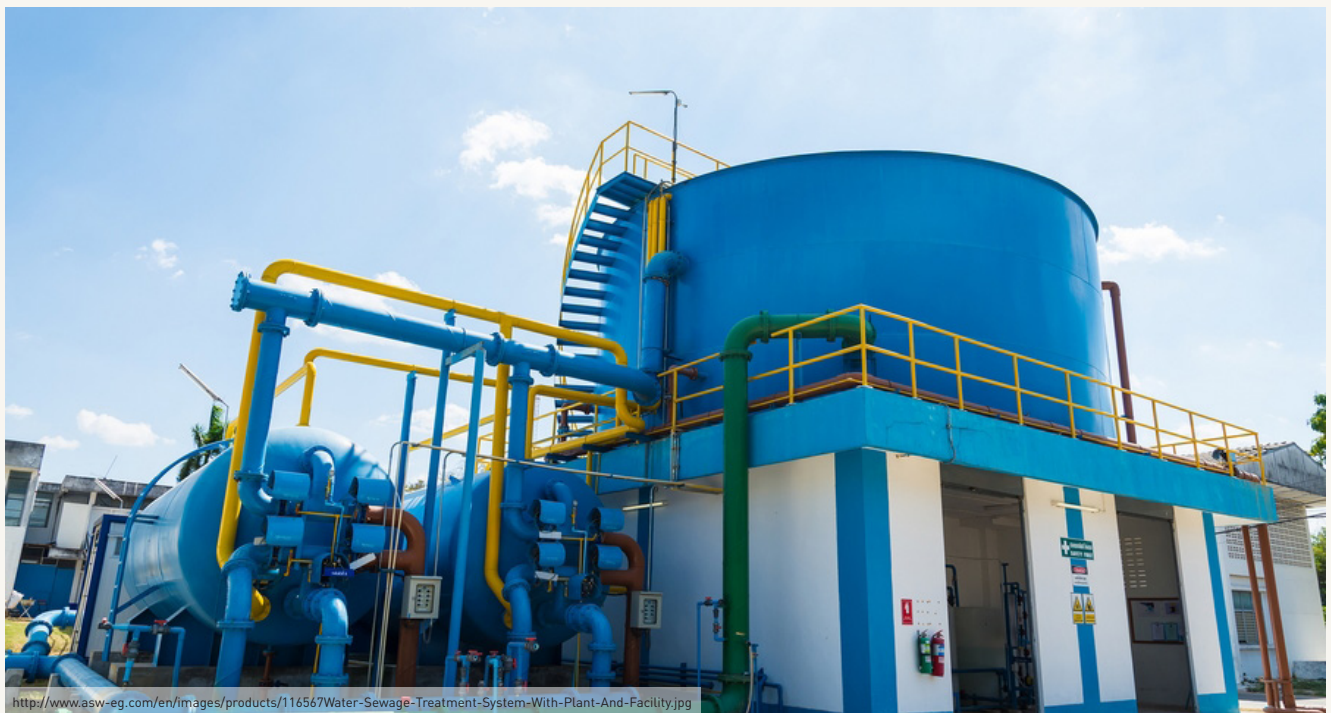
Endüstriyel Atıksu Arıtma Tesisi
