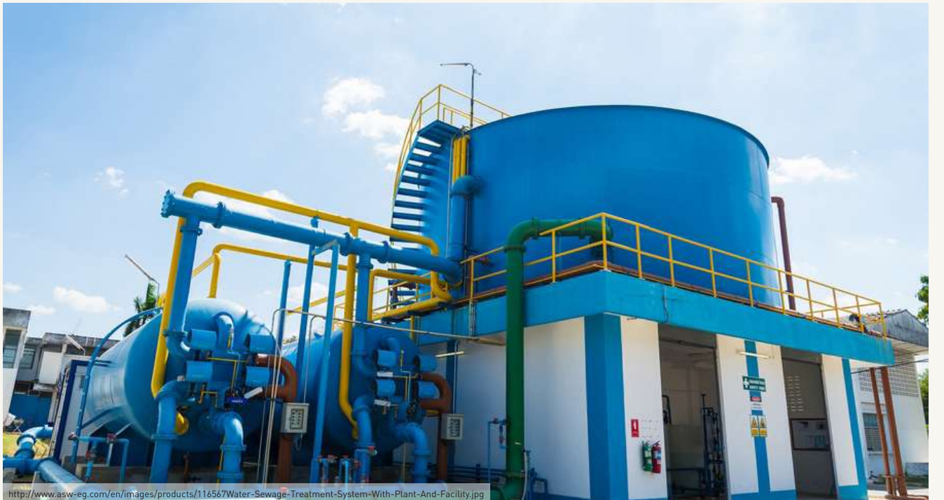
Endüstriyel Atıksu Arıtma Tesisi
