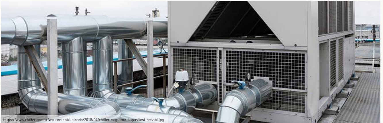
Soğutma Sistemleri (Chiller)
