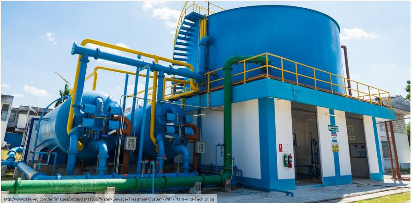
Endüstriyel Atıksu Arıtma Tesisi
