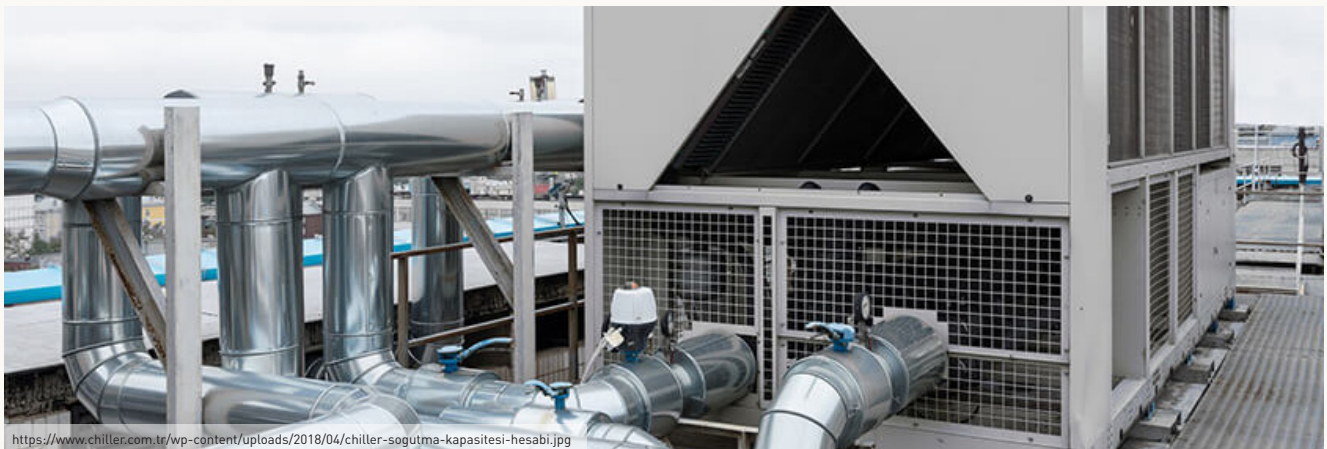
Soğutma Sistemleri (Chiller)
