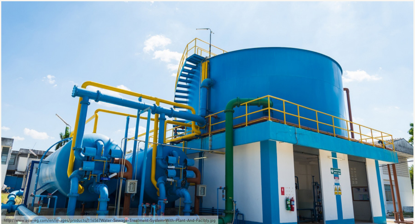
Endüstriyel Atıksu Arıtma Tesisi
