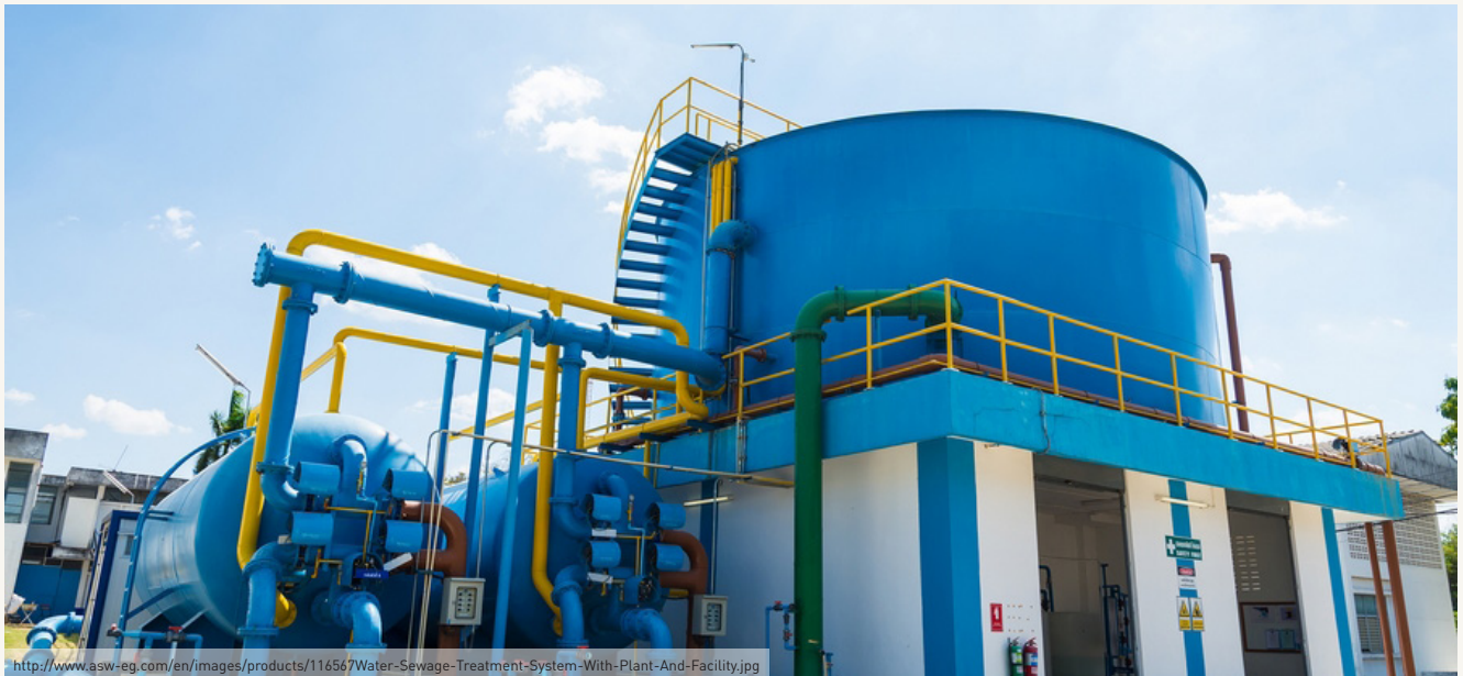
Endüstriyel Atıksu Arıtma Tesisi
