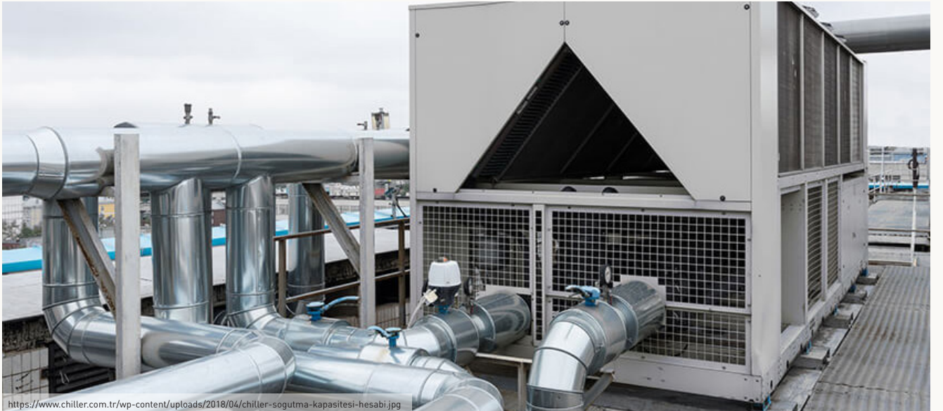
Soğutma Sistemleri (Chiller)
