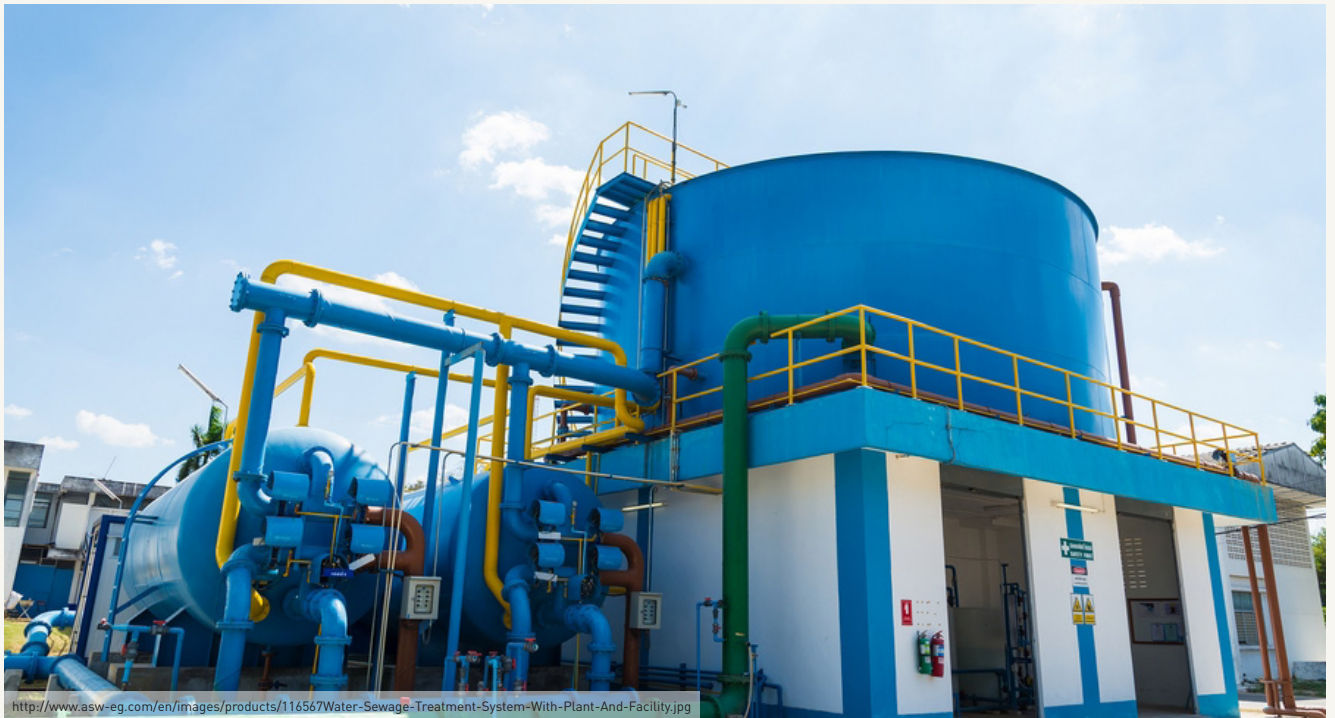
Endüstriyel Atıksu Arıtma Tesisi
