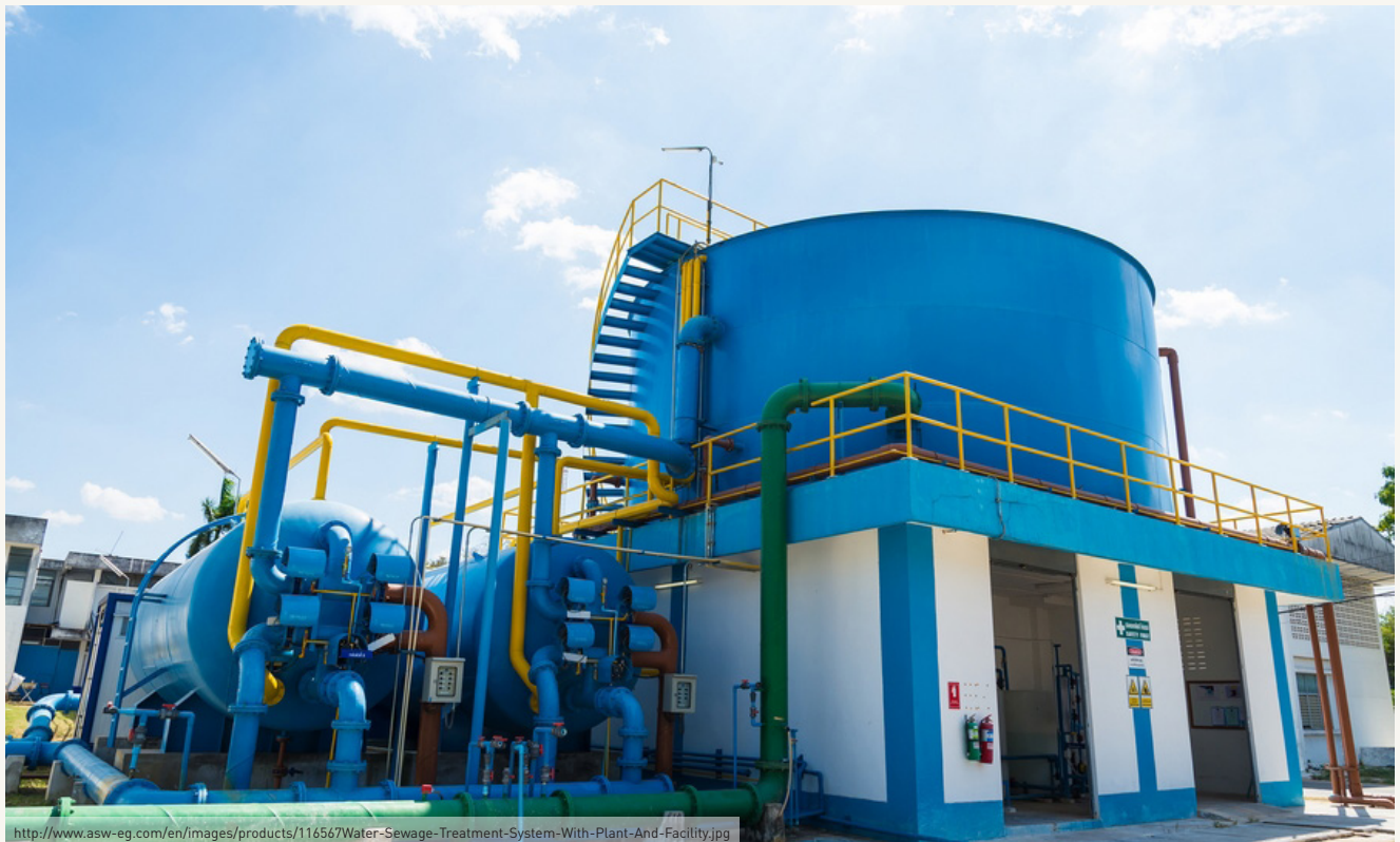
Endüstriyel Atıksu Arıtma Tesisi
