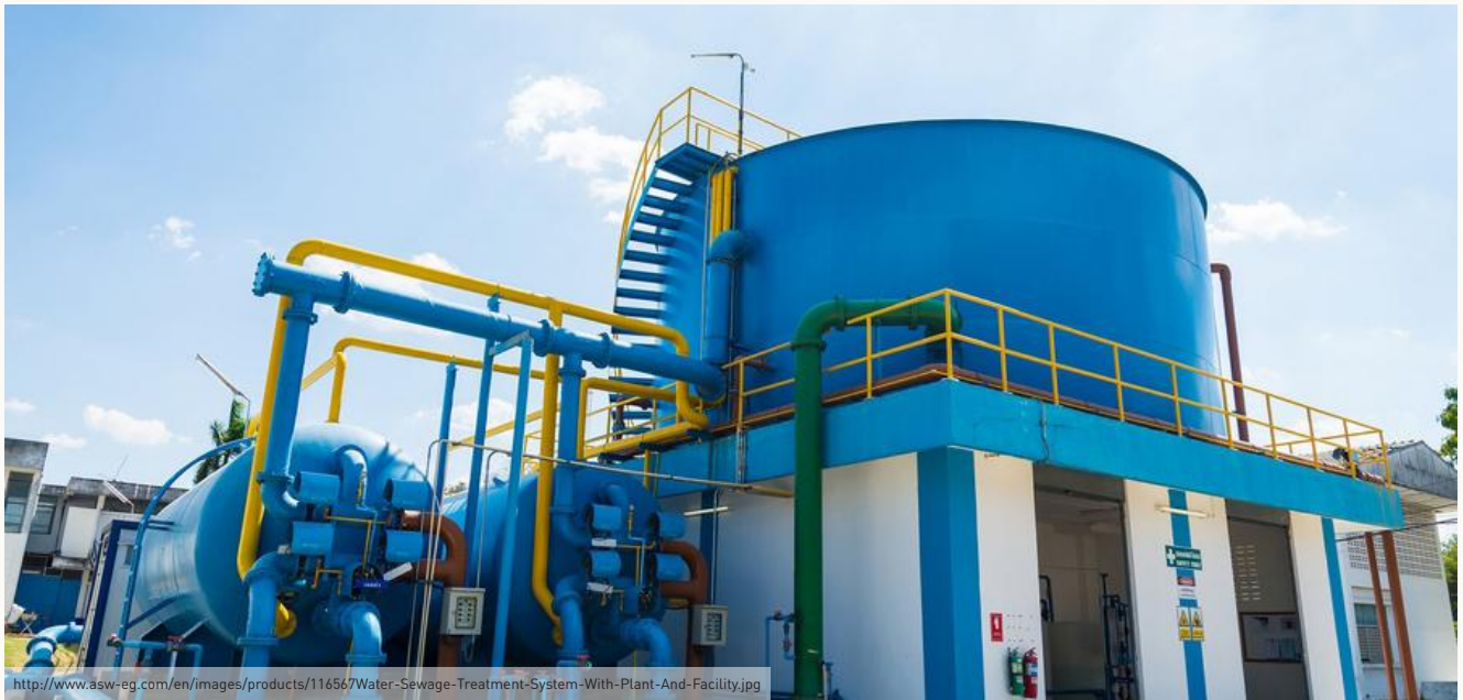
Endüstriyel Atıksu Arıtma Tesisi
